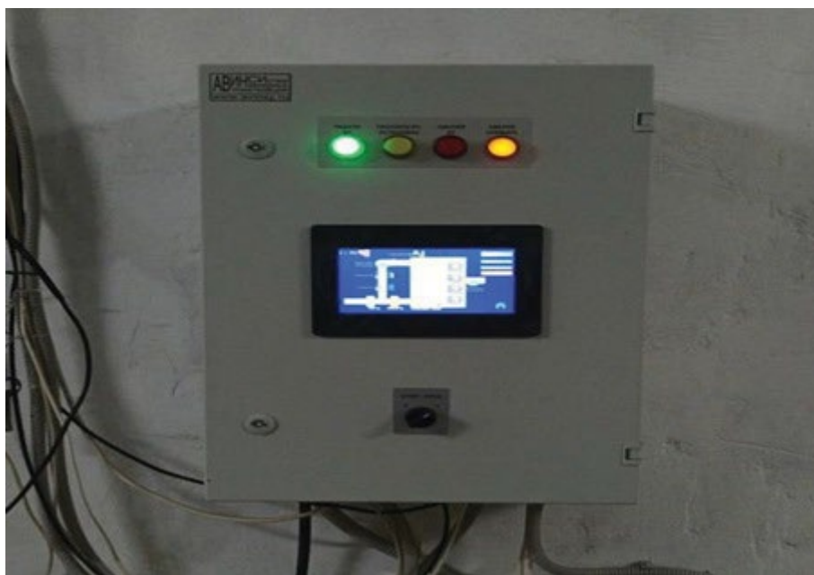
Рисунок 3.1 – Шкаф с компьютером для управления климатической установкой
